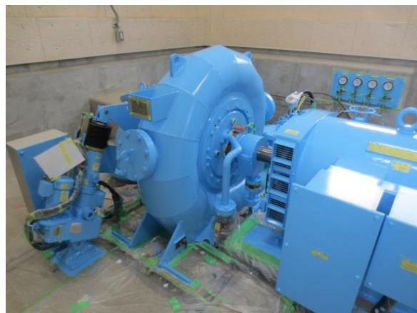
▲日野川用水発電所（塗装完了）
