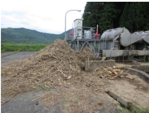
▲八乙女頭首工除塵機 (流入した大量の流木とゴミ)
