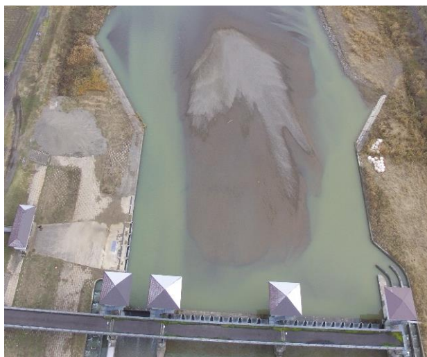
▲堆積土砂状況（上流部）
