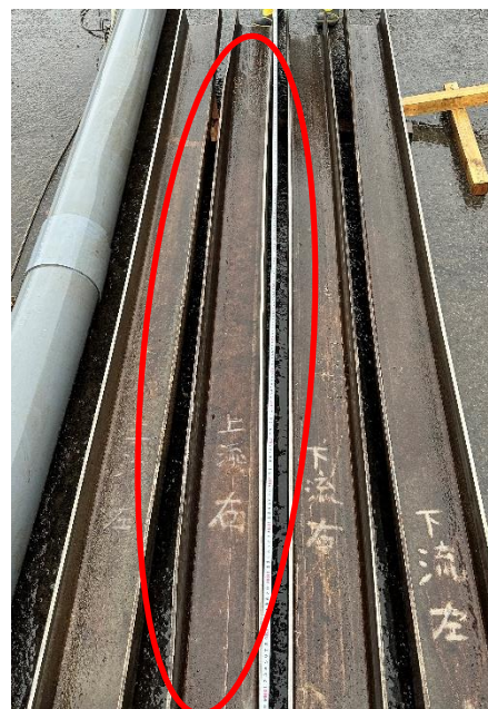
▲変形したガイドフレーム
